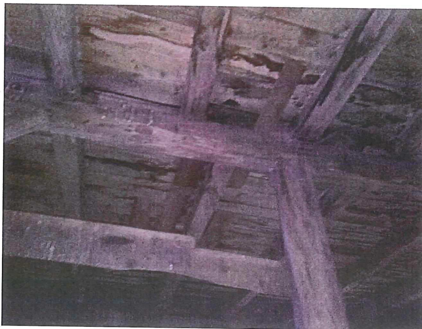
Rys. 5 Widoczne zawilgocenia elementów więźby dachowej
