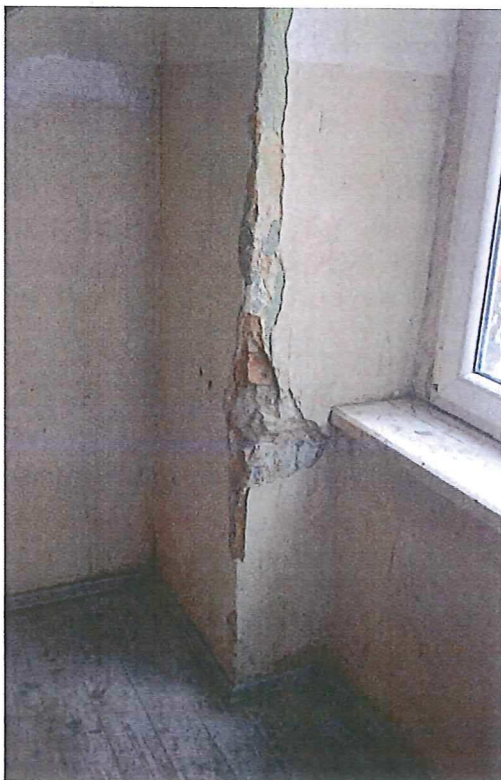
Rys.3 Widoczne odrapania i spękania tynków
