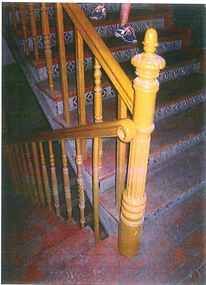
Rys.2 Widoczne niepasujące elementy drewniane schodów
