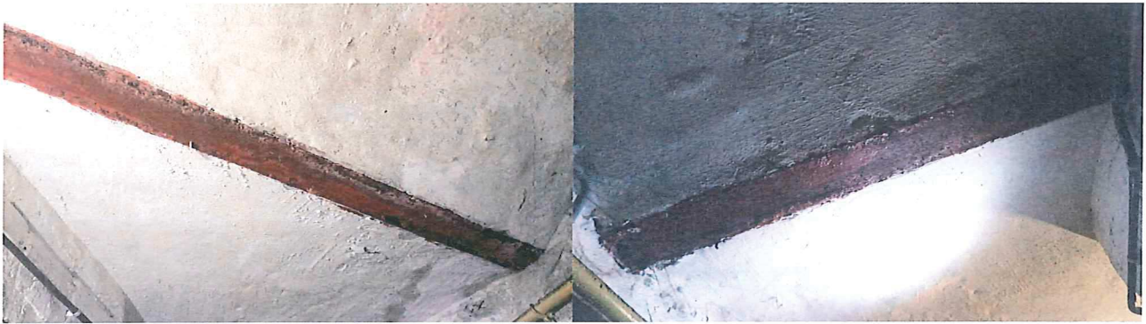
Zdj. 2 skorodowane belki stalowe stropu nad piwnicą
