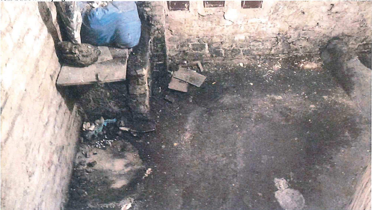
Zdj. 1 posadzka piwnicy.
