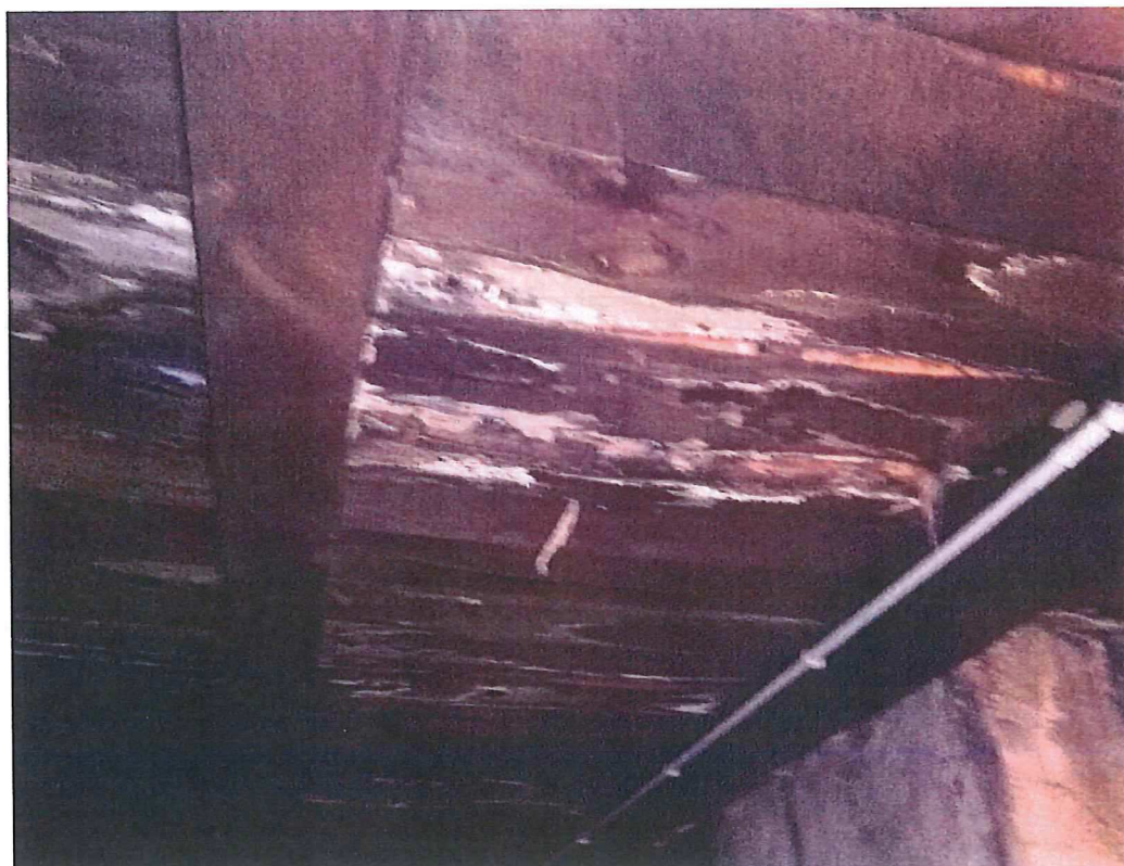
Rys. 5 Widoczne zawilgocenia elementów więźby dachowej
