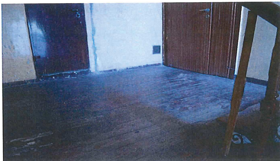
Rys. 2 Widok zniszczonych elementów klatki schodowej
