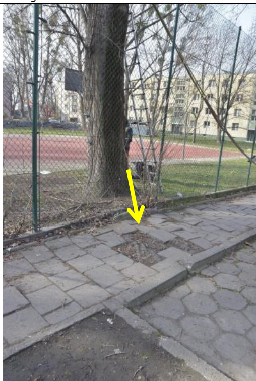
Fot. 5-3 Topola kanadyjska ID 8151, ul. Ciepła 15, Wrocław. Korzenie podnoszą kostki bruku ciągu pieszym wzdłuż ogrodzenia.
