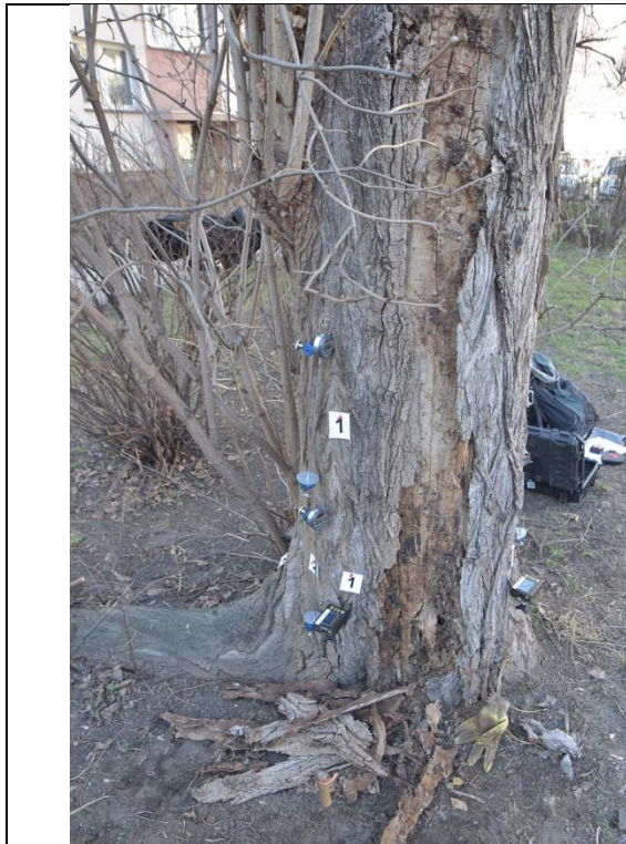
Fot. 9-7. Topola włoska ID 13885, ul. Hubska 41-53, Wrocław. Próba obciążeniowa - miejsce mocowania czujników - strona ściskana
