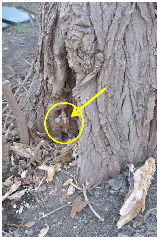
Fot. 6-2. Topola włoska ID 13881, ul. Hubska 41-53, Wrocław. Dolna część pnia. Rozkład drewna u podstawy sprawdzony sondą (wskazana kołem i strzałką).
